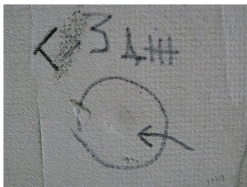
а) Ударная прочность < 3 Дж. Трещина в месте удара
