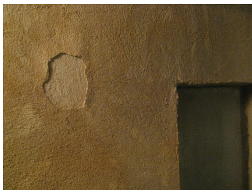
а) частичное разрушение
