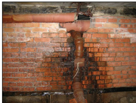
Рисунок 4. Увлажнение стены вследствие протечек системы канализации
