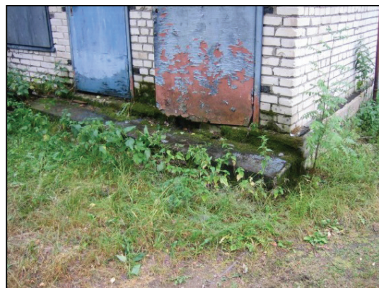
Рисунок 2. Биоповреждение цокольной зоны
