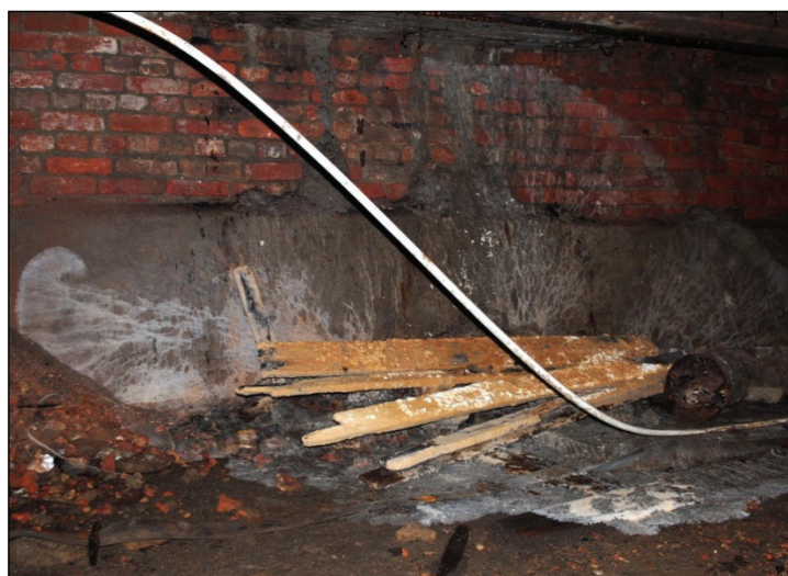
Рисунок 8. Домовой гриб на кирпичной кладке
