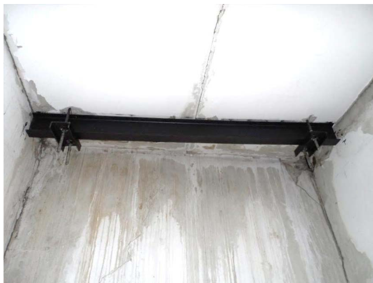
Рисунок 17. Щели в стыках плит покрытия и стен лестничной клетки
