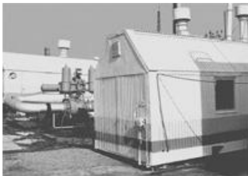
Рисунок П.2.8. Утилизационная энергетическая установка УТДУ-2500 ОАО «Турбогаз» Объекты ОАО «Турбогаз»
