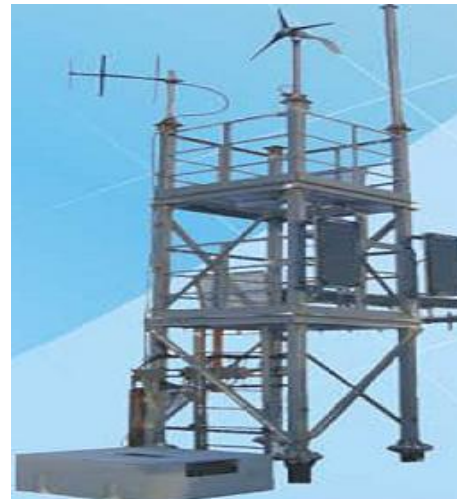
Рисунок П.1.26. Монтажная мачта НПО «Вымпел» с установленной аппаратурой
