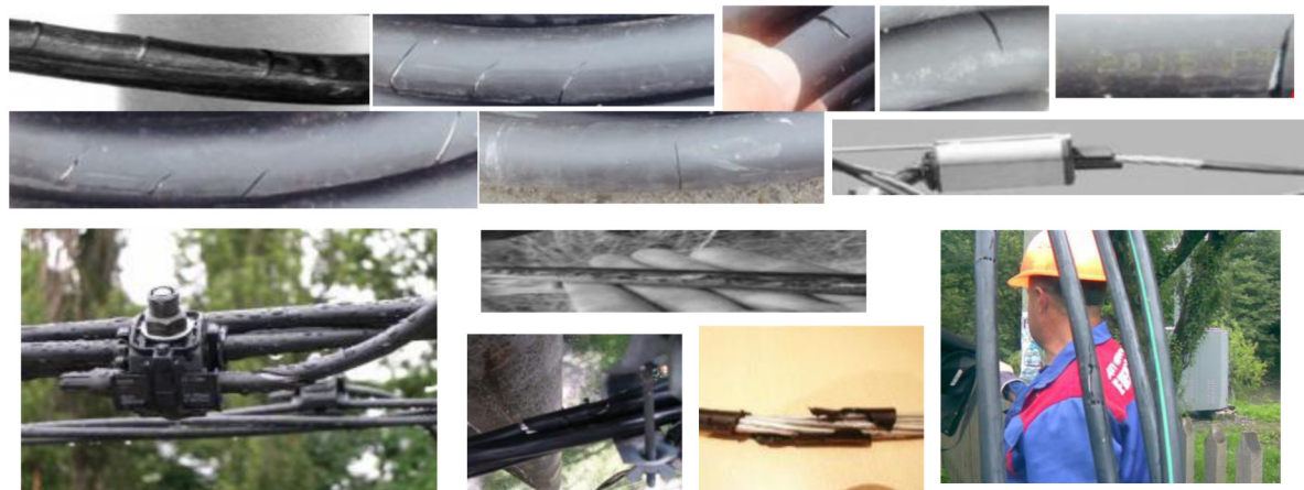
Рис. 1. Образование трещин в ПЗИ проводов
