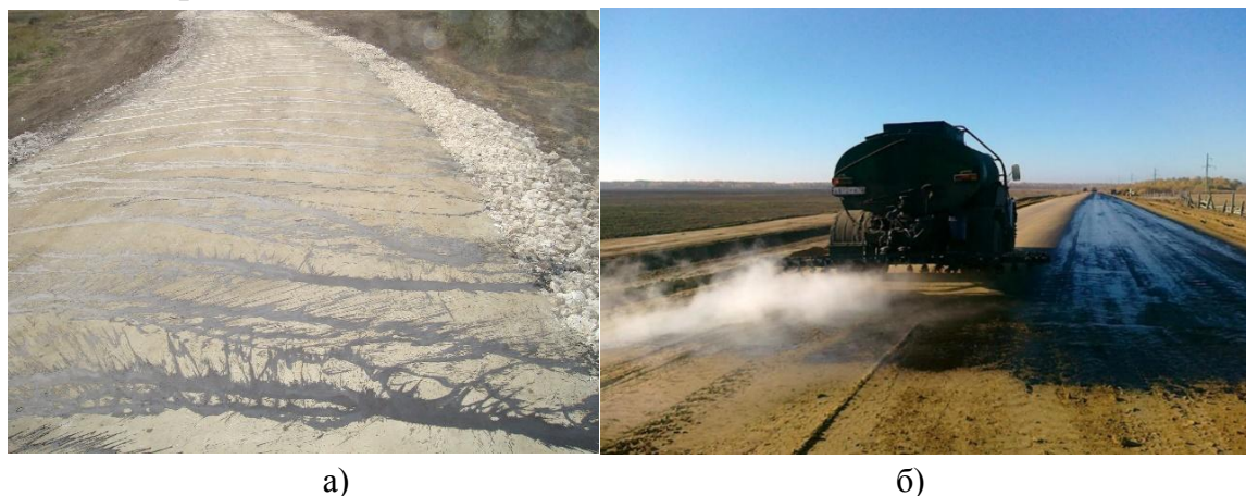
Рисунок 2.12. Подготовка дорожного полотна перед укладкой асфальтобетонной смеси: а) неприемлемое качество; б) приемлемое качество
