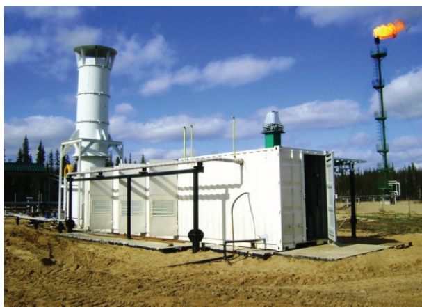
Рис. 5. Установка для сжигания подтоварной воды с утилизацией попутного нефтяного газа
