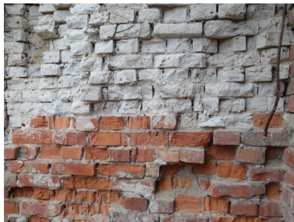
Рисунок 4. Фото поврежденной стены здания
