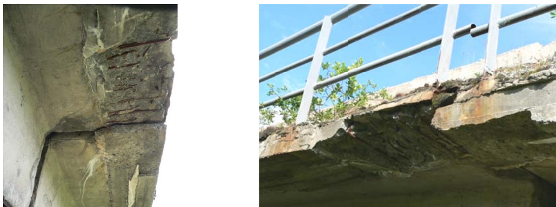
Рисунок 1. Автодорожный мост с участком локального разрушения вследствие коррозионного растрескивания [16]
