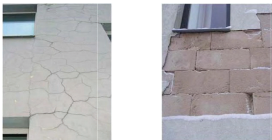
Рисунок 9. Разрушение и отслоение штукатурного покрытия от газобетонной кладки [21]
