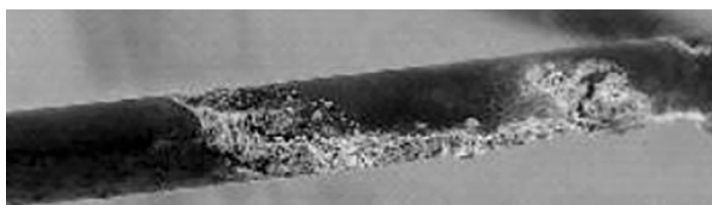
Рис. 7. Наблюдаемая эрозия поверхности защищенного провода при верхних предельных значениях зарегистрированного тока утечки
