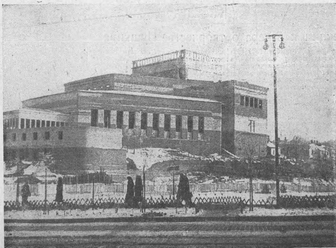
К XX годовщине Великой пролетарской резолюции будет закончено строительство грандиозного драматического театра в гор. Иванове по проекту архитектора А. В. Власова. В театре два зала на 1400 и 400 мест. Уже закончена кладка стен театра, устилавляются фермы и ведутся внутренние отделочные работы На снимке—драматический театр в гор. Иванове
