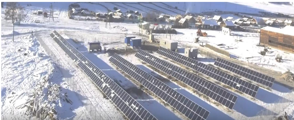
Рис. 1.36. Вид энергокомплекса СЭС-ДЭС-АС в п. Менза
