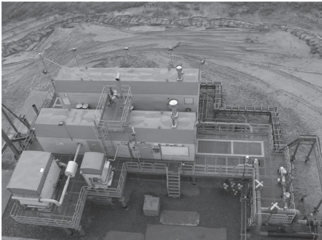
Рис. 5. МКУ типа ТАКАТ на площадке КГС-611 Ямбургского НГКМ
