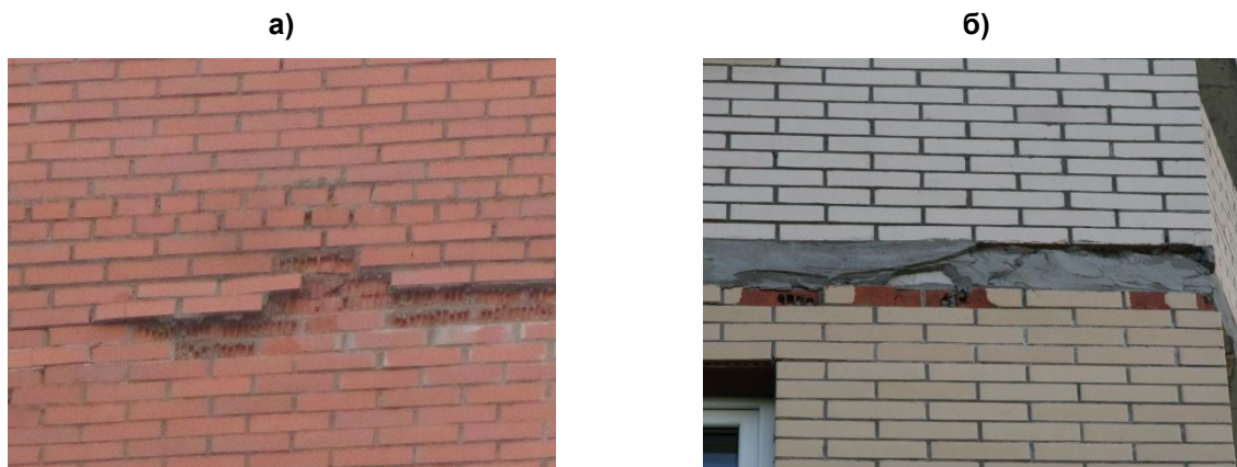
Рисунок 1. Характерные дефекты лицевого каменного слоя в зоне сопряжения с железобетонными дисками перекрытий
