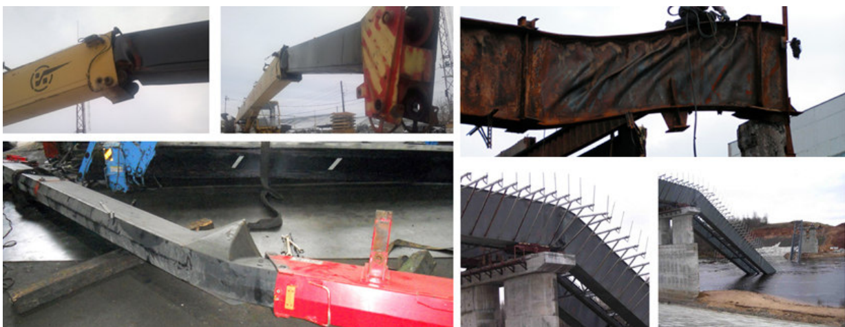
Рис. 1. Потеря местной устойчивости элементов подъемно-транспортных машин и мостов Fig. 1. Loss of local stability of elements of carrying and lifting machines and bridges
