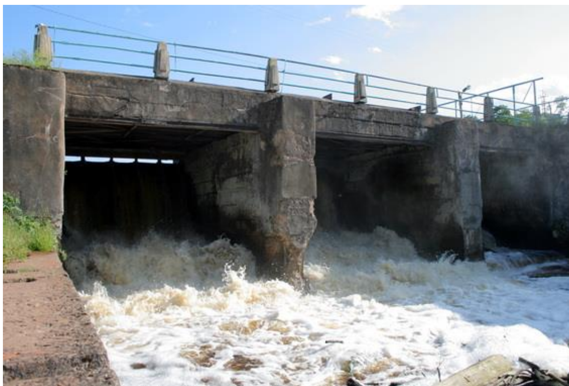
Рис. 3. Состояние водосбросов Рождественской ГЭС
