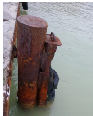
Рис. 3. Деформация, поверхностная коррозия металлического короба отбойного устройства, полное разрушение резинового цилиндра на Пассажирском пирсе в районе сада им. Караева
