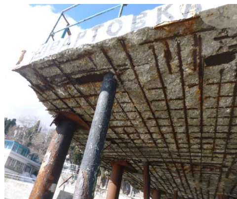
Рис. 2. Разрушение бетона на нижней поверхности верхнего строения с обнажением и коррозией рабочей арматуры на причале в Алушке
