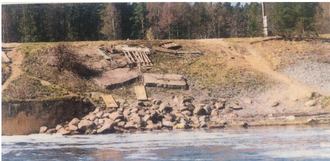
Рис. 2. Разрушения грунтовой плотины Вырицкого гидроузла
