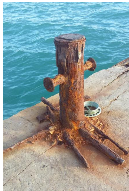
Рис. 4. Поверхностная и язвенная коррозия кнехта и как следствие полное разрушение швартовного устройства на Пассажирском пирсе «Парк Фрунзе»
