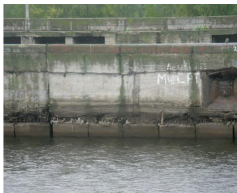
Рис. 3. Разрушения в зоне переменного уровня
