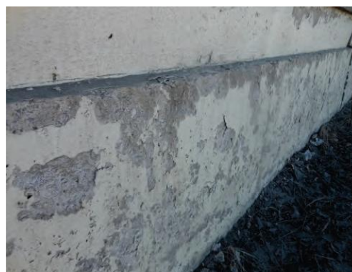
Рис. 4. Отслаивание защитного слоя (до 60%)
