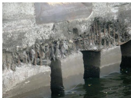
Рис. 2. Вынос продуктов разрушения (бетонного камня)
