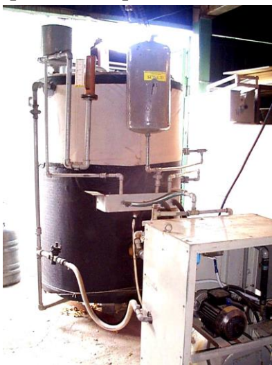
Рисунок 30. Фото БГУ-1,5 УрФУ. На переднем плане – блок вспомогательных устройств с системой управления
