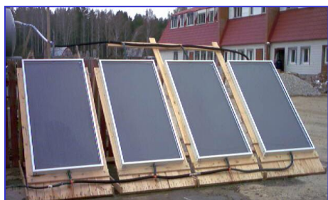
Рисунок 18. Солнечные коллекторы на объекте «Энергоэффективный дом»
