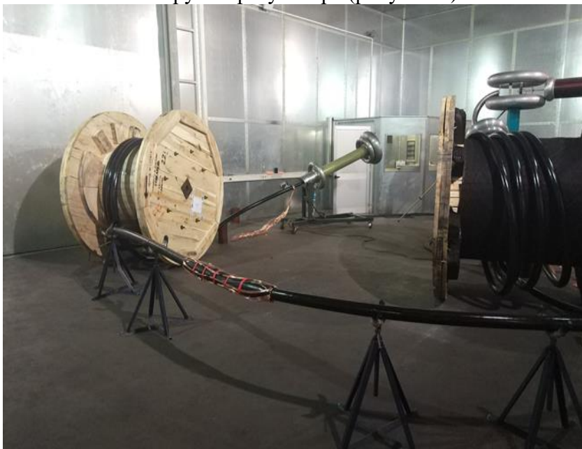
Рисунок 7. Подготовленная к испытаниям кабельная линия на 110 кВ с соединительной муфтой типа «трубки-регулятор».
