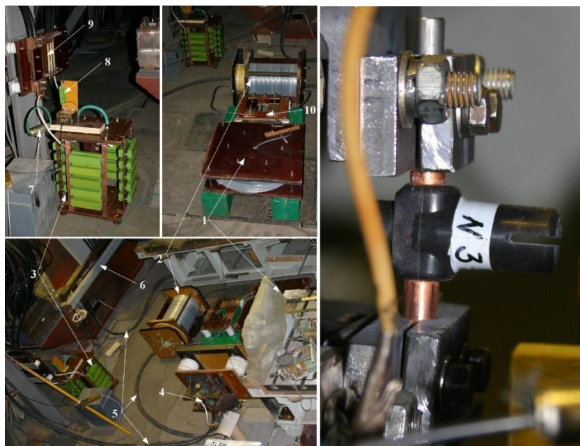
Рисунок 14. Общий вид экспериментальной установки: 1 – катушка индуктивности L_{KK} , 2 – катушка индуктивности связи L_{KG} , 3 – модуль сопротивлений ГИТ R_{ГИТ} , 4 – токовый шунт, 5 – подводящие кабели, 6 – токовый коллектор накопителя, 7 – пояс Роговского, 8 – делитель напряжения, 9 – токовый коллектор ГИТ, 10 – токовый коллектор КК
