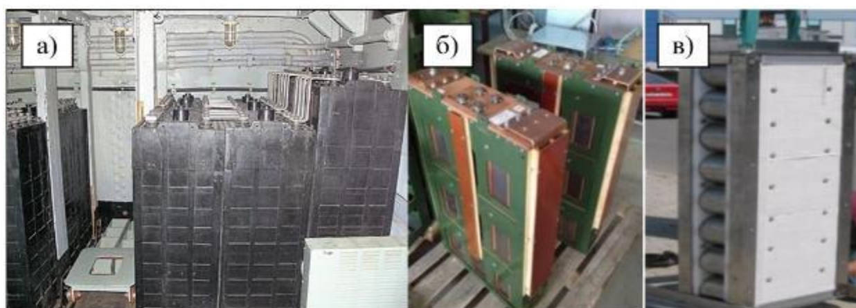
Рисунок 1.3 – Аккумуляторы, применяемые в морском флоте: а) свинцово-кислотные АБ (аккумуляторное помещение проекта «Д-2» [50]); б) прототип литий-ионной АБ (совместная разработка аккумуляторной компании «Ригель» и ЦКБ МТ «Рубин» [51]); в) зарубежный образец литий-ионной АБ (разработка компаний «Yardney», «Lithion» (США), «SAFT» (Франция) и «GAIA» (Германия) [51])
