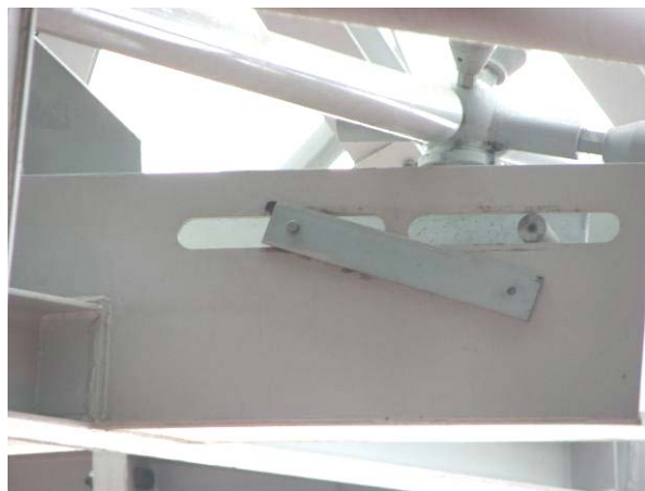
Рис. 5.19. Ослабление и выпадение болтов крепления катка подвижной опоры структурного блока покрытия
