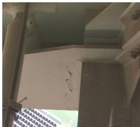
Рис. 5.15 Отслоение лакокрасочного покрытия
