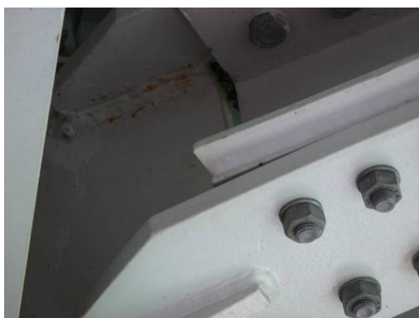
Рис. 5.16 Зазор до 2 мм между фасонкой и элементом решетки
