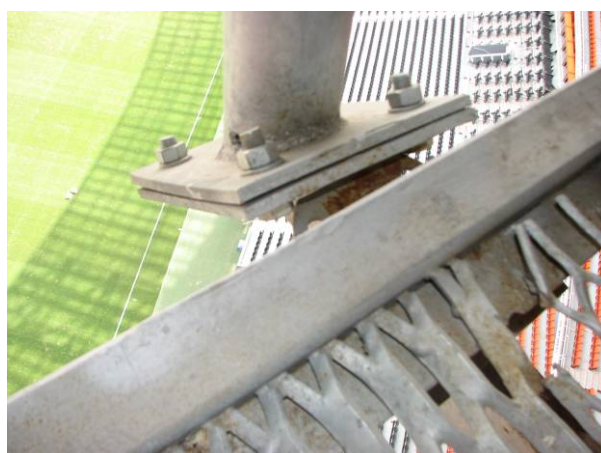
Рис. 5.17 Зазоры между фланцами крепления стоек ограждения
