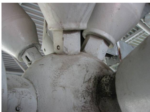
Рис. 5.20. Разрушение лакокрасочного покрытия шаровых вставок
