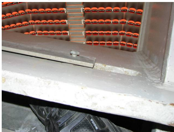
Рис. 5.18. Ослабление элементов болтового крепления катка подвижной опоры блока структурного покрытия
