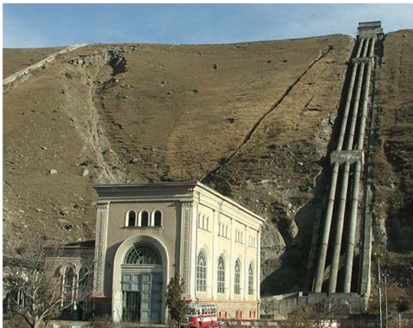
Рис. 1.1. Турбинные трубопроводы Эзминской ГЭС
