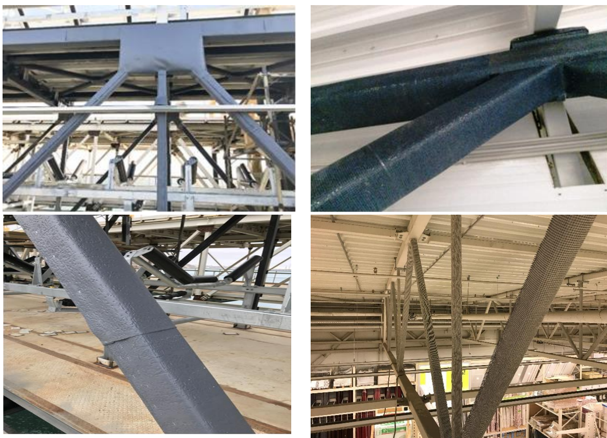
Рисунок 36 – Защищенные интумесцентной сеткой стальные конструкции, в том числе и для наружной эксплуатации в морском климате
