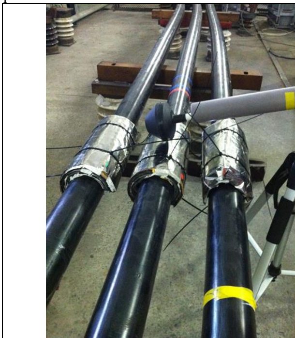
Рис.10 Кабельная линия, проложенная в горизонтальной плоскости
