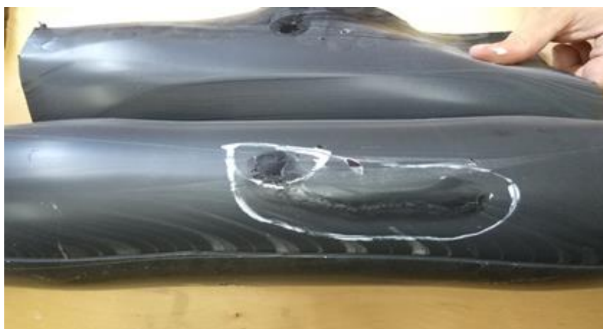
Рисунок 30 Пробой слоя усиливающей изоляции
