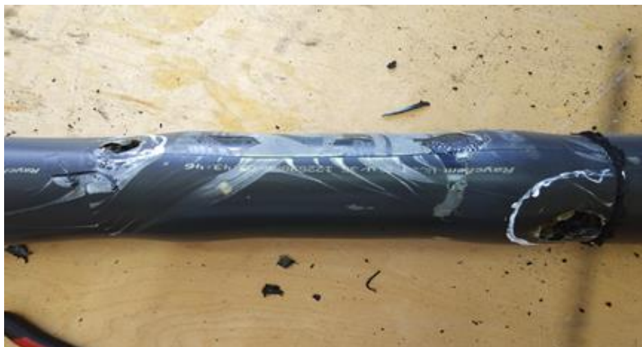
Рисунок 31 Прожог усиливающей изоляции по обе стороны от соединительной гильзы
