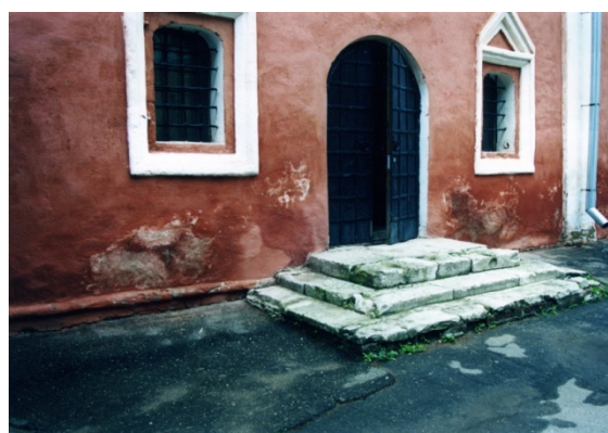
Рисунок 7. Высолы на фасаде
