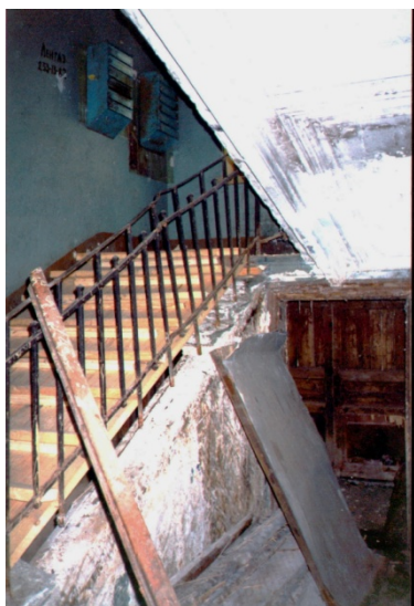
Рисунок 10. Ропшинская ул., д.12. Бетонный трап обрушился под человеком. Основной биодеструктор – актиномицеты
