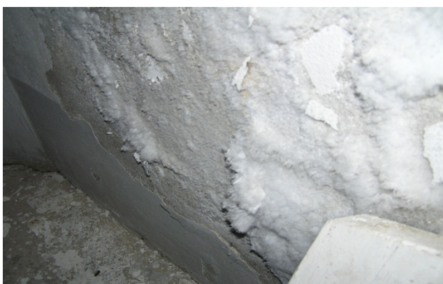
Рисунок 6. Высолы на стенах подвала
