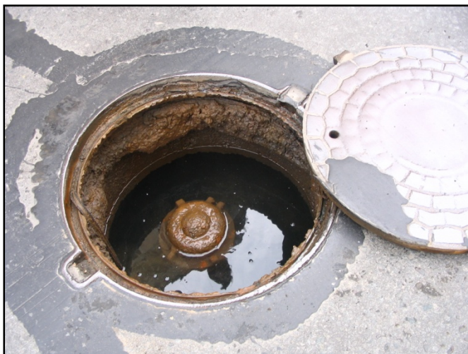
Рисунок 12. Люк пожарного водоснабжения залит водой из-за утечки в сети холодного водоснабжения
