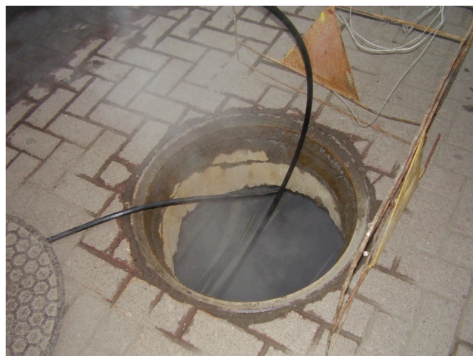
Рисунок 13. Телефонный коллектор залит горячей водой из системы центрального отопления
