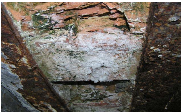
Рисунок 8. Биоповреждение несущих балок и кирпичных сводиков перекрытий над подвалом
