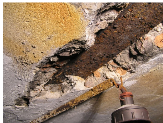
Рисунок 9. Биокоррозия несущей двутавровой балки
