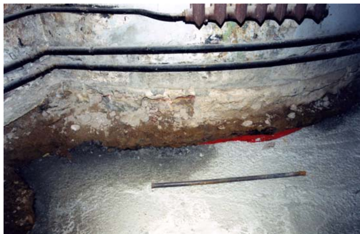
Рисунок 20. Увлажнение в зоне прямого контакта бетонной плиты и кладки на известковом растворе
