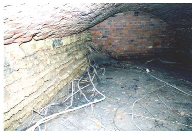
Рисунок 16. Фундамент пробит корнями тополя
