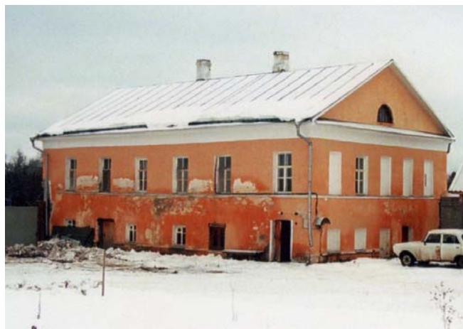
Рисунок 18. Разрушение фасада из-за капиллярного эффекта, который обусловлен повышением культурного слоя
